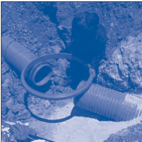
3 Se corta un aro (corrugada) del cuerpo del pozo, y se sitúa sobre los extremos del colector.
