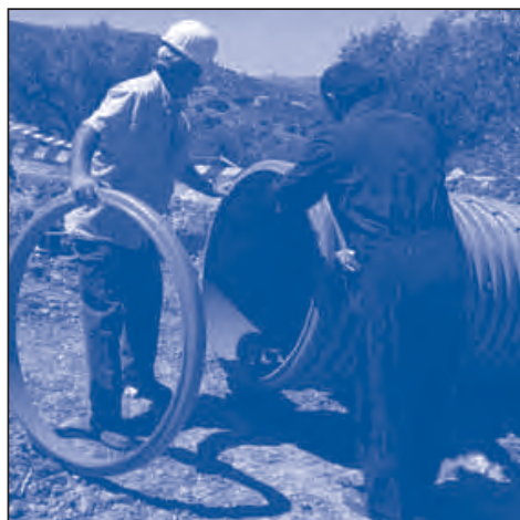
5 Se coloca el aro marcado en la base del pozo, teniendo en cuenta cual va a ser su posición en la zanja, y se marca la posición de los ejes de los entronques.
